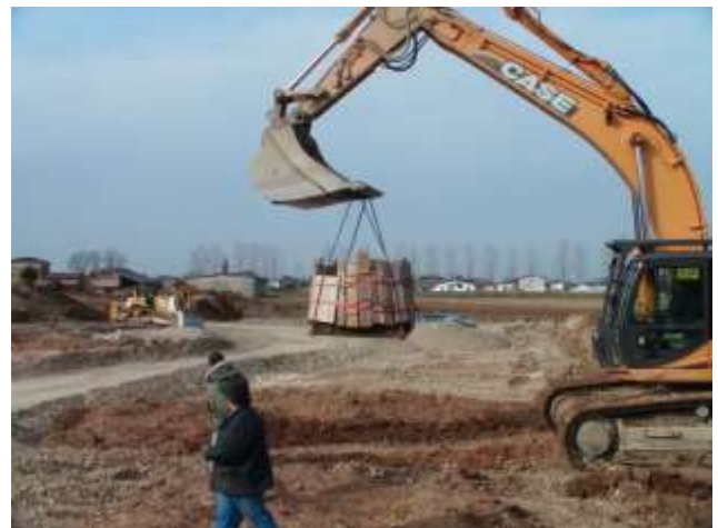
Prelievo del pozzo n° 1
