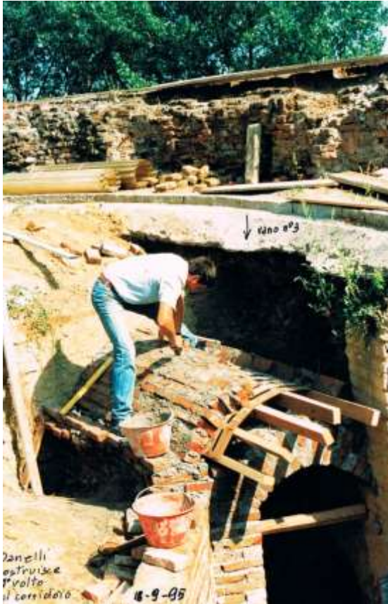
Inizio della costruzione del voltino del corridoio di fronte al vano n°3.
