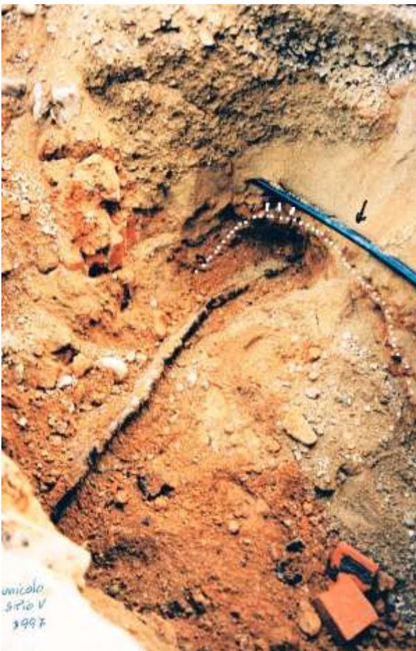
Resti del volto del cunicolo crollato durante lo scavo per il guasto del cavo elettrico.
