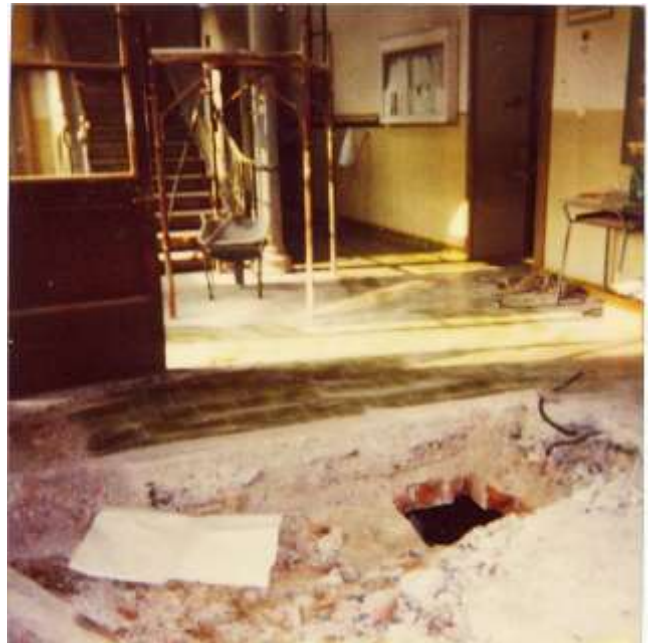
Il pavimento dell'atrio del vecchio edificio delle scuole demolito per la realizzazione dell'ascensore
