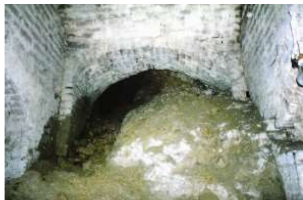
Il cumulo di materiale che ostruisce il passaggio.
