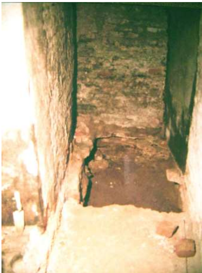
Rottura nel pavimento dell'atrio verso Est: è evidente che si tratta di un volto di cunicolo.
