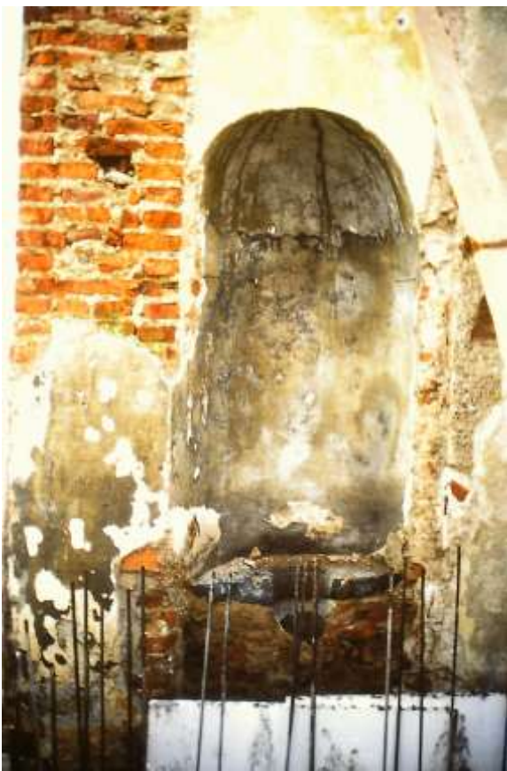
Come appariva la nicchia durante i lavori di consolidamento in cemento armato delle fondazioni.
