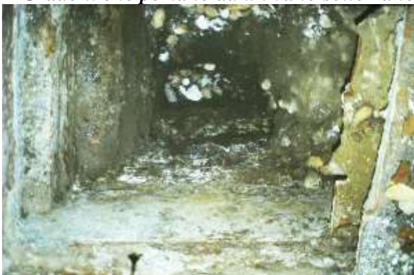
Caditoia di scarico liquami
