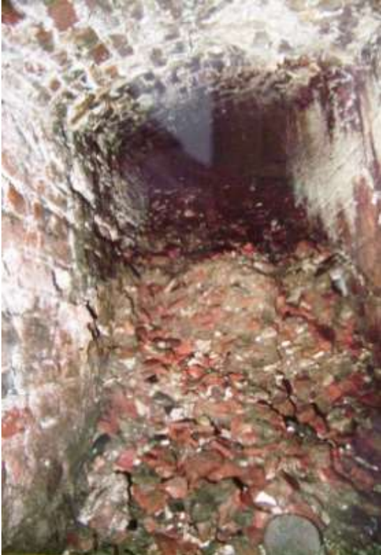
Come appariva la scala completamente sommersa da materiale di scarico.
