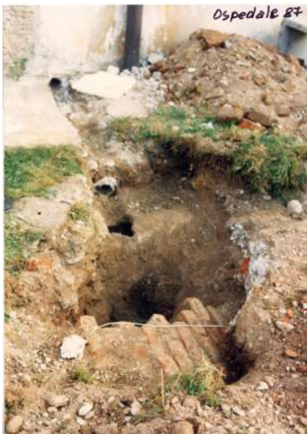
La voragine con la struttura del cunicolo.
