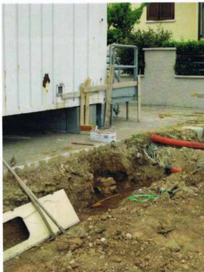
23 - Lo scavo a lato dell'area riservata al prefabbricato della Società del telefono, con l'individuazione del muretto.
