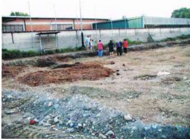
43 - Il Presidente di Aquaria, mentre sorveglia che nessuno provochi danni agli scavi aperti ed incustoditi, si improvvisa cicerone e guida.
