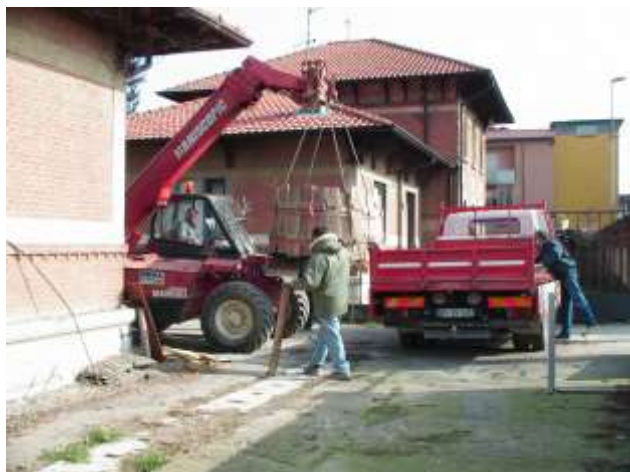
Il pozzo viene scaricato presso il magazzino comunale dell'acquedotto.
