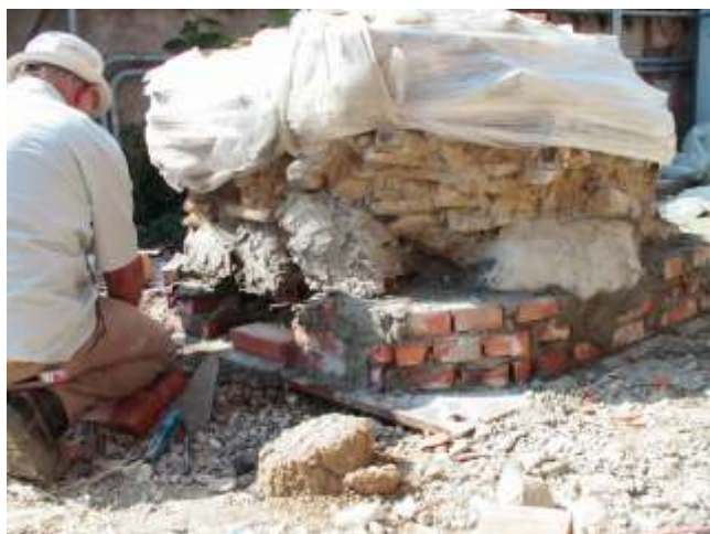
Un esperto muratore completa il consolidamento di tutto il complesso del pozzo.
